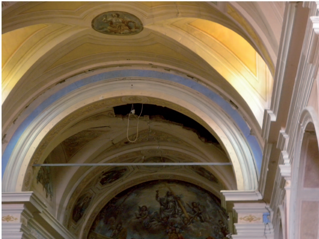
Nella foto, al centro, una crepa nella volta della chiesa di Medolla
